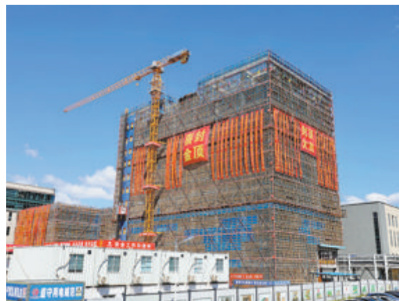
2022年9月28日,海辰储能厦门总部基地联合封顶。(本报记者 王协云 摄)
