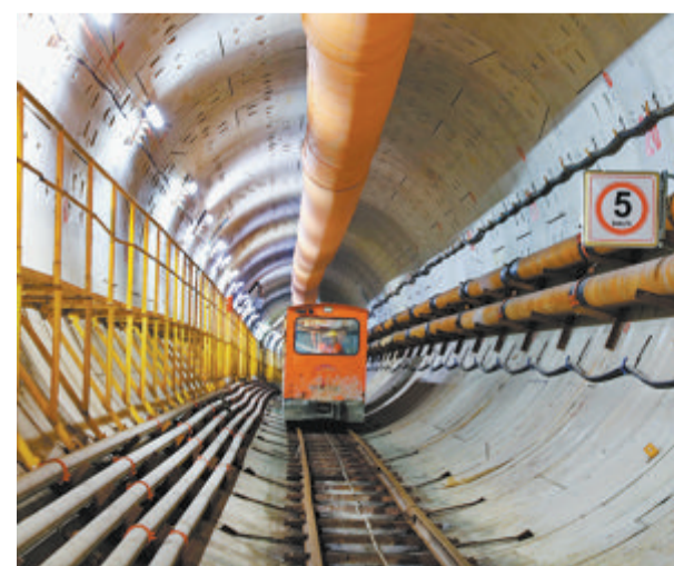
▲厦门地铁2号线是国内第一条海底盾构地铁隧道。图为施工中的2号线过海隧道。
