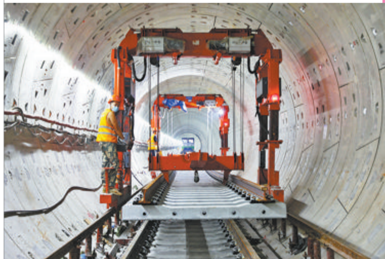
▲厦门地铁2号线是国内第一条海底盾构地铁隧道。图为施工中的2号线过海隧道。
