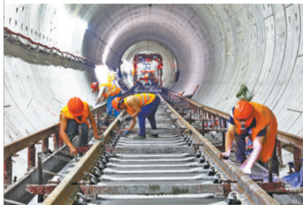
▲7月20日,地铁6号线林埭西至华侨大学段正式启动铺轨作业,图为6号线林埭西站至马銮西站右线铺轨现场。
