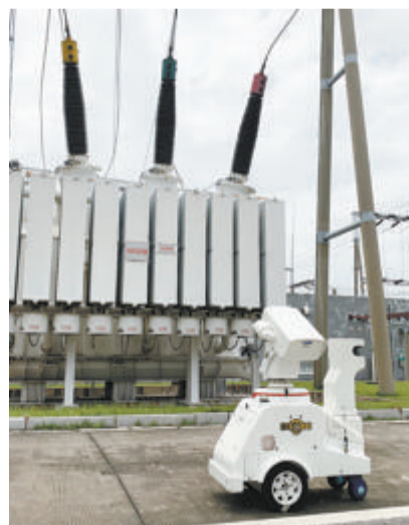
厦门供电公司变电运检人员利用无人机、机器人等开展网格化智能联合巡视。(李盛川摄)
