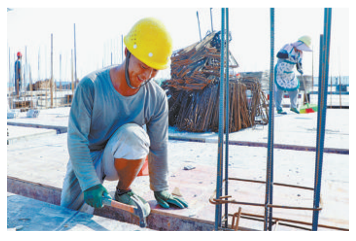
▶软件园三期西片区I05地块,园区建设者投入到项目建设中。 ▼信息集团员工正在“创+驿站”为园区企业办理业务。
