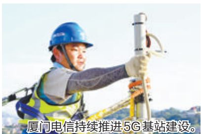
厦门电信持续推进5G基站建设。
