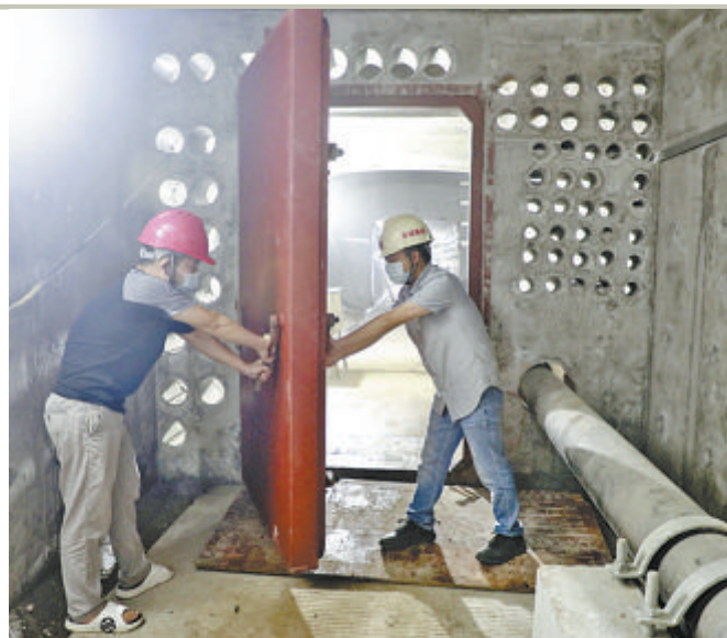
走进人防试验段，在其终端可见一堵蜂窝状人防墙，这些墙上孔洞是预留给下一步管线架设使用的。
