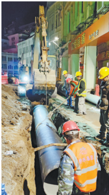
▲我市大力推进老旧供水管网改造，减少管网漏损。(本报资料图)
