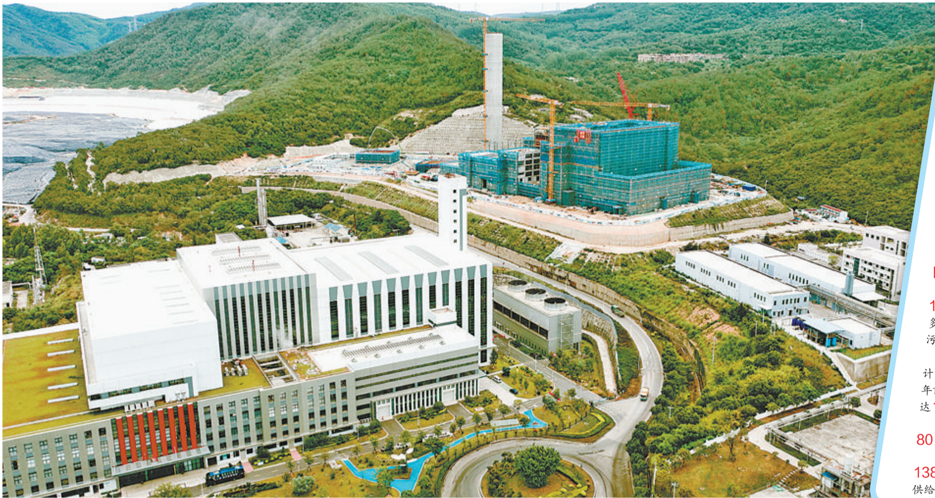
厦门市政集团高标准推进市政设施建设和管理,深度服务跨岛发展。图为翔安再生能源电厂。
