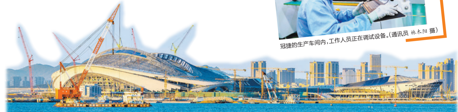
翔安各大新城的建设发展如火如荼。图为新体育中心施工现场。(本报记者 王火炎 摄)
