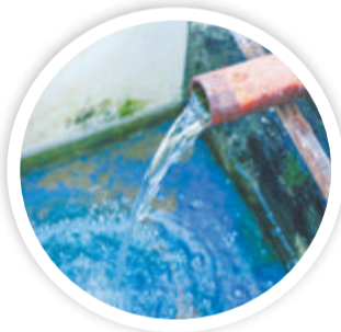
新圩面前埔村尾水处理站,经过处理排出的尾水达到“一级A”排放标准。
