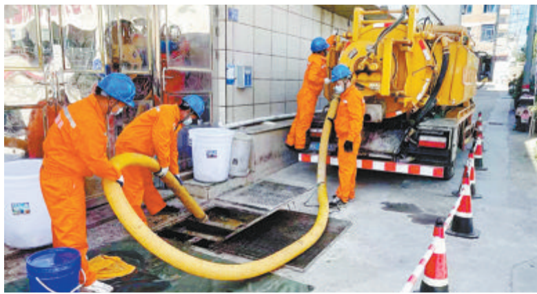
翔安市政集团水务管理有限公司工作人员正对污水管道进行日常维护、清理。(受访单位供图)
