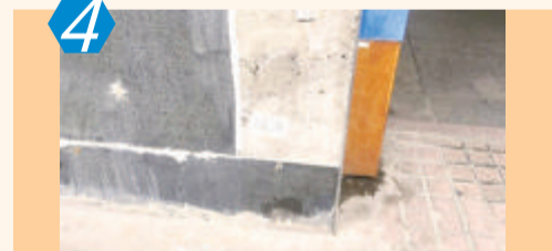
4 测评项目:“回头看”背街小巷 测评点位:思明区筲箕街道无名路(岳阳西里) 测评情况:该点位沿街存在外立面脱落破损、设施残留未清除问题;路面垃圾积存、店面广告乱张贴、电动车乱停放等问题较多,测评成绩72.00分(上一轮测评成绩74.00分)。
