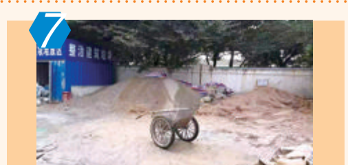
7 考评项目:扬尘防治(专项考评) 项目名称:厦门市湖里区2021P03地块 监管单位:市建设局 建设单位:厦门兆元盛房地产开发有限公司 考评情况:该项目场内地面存在较厚浮土积尘,易扬尘的散装物料及建筑材料未覆盖。
