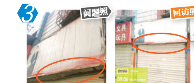
3 问题照 回访照 湖里区竹坑路22-10号户外广告破损问题。经现场核查,该问题未整改。
