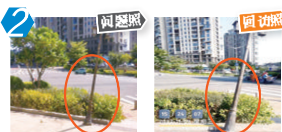
2 问题照 回访照 思明区侨岳路321-103号路灯杆倾斜问题。经现场核查,该问题未整改。
