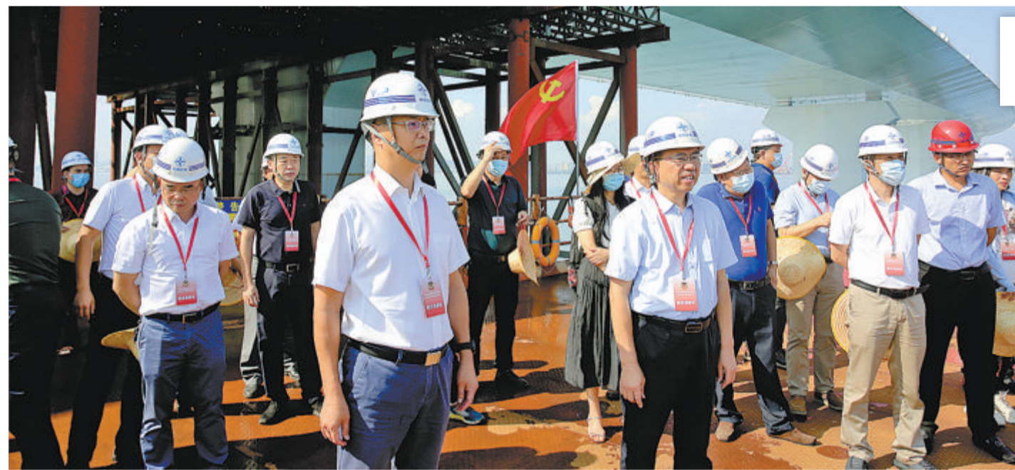
翔安区政协常委一行实地察看翔安大桥建设情况并听取路桥集团介绍施工计划。
