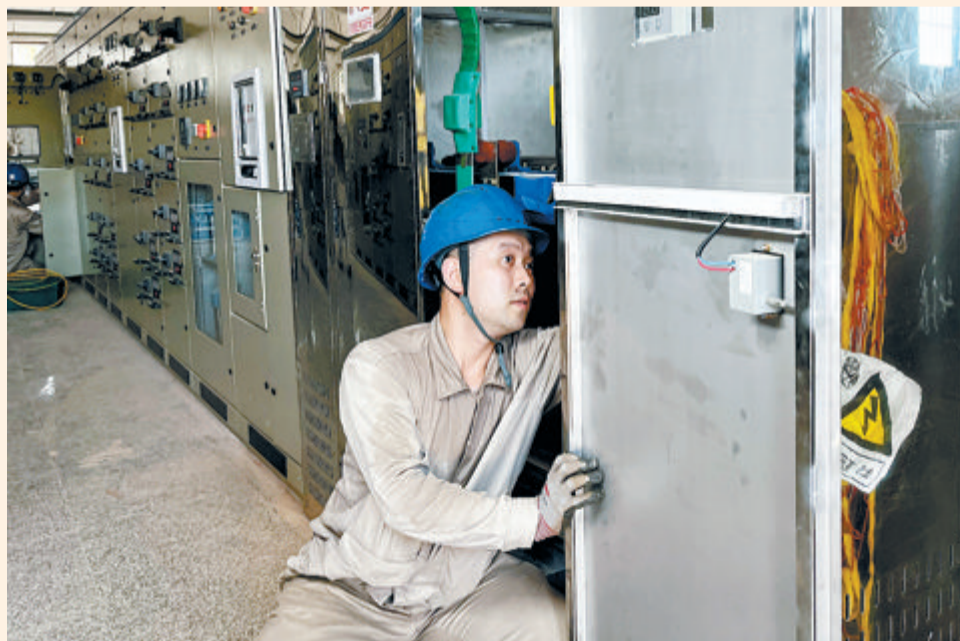
▲新能源科技公司工作人员正在进行送电前的配合整改工作。
