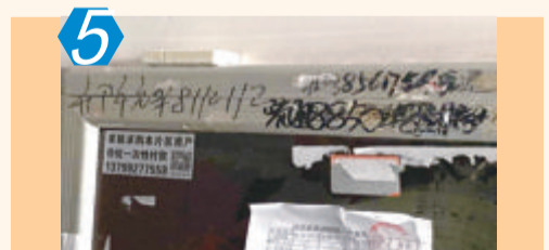
5 测评项目:“回头看”小区 测评点位:思明区自然家园 测评情况:该点位主要存在楼道内乱堆杂、乱摆放,乱涂写,楼道墙面、设施破损、脏污,路灯灯杆和基座盖破损,侵占或损坏公共场所、绿地,电动车乱停放和卫生保洁不到位等问题,测评成绩61.00分(11月份测评成绩44.00分)。
