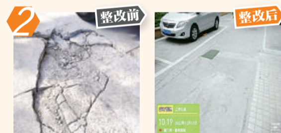
2 湖里区嘉园路30-4号路面破损。经现场核查,该问题已完成整改。
