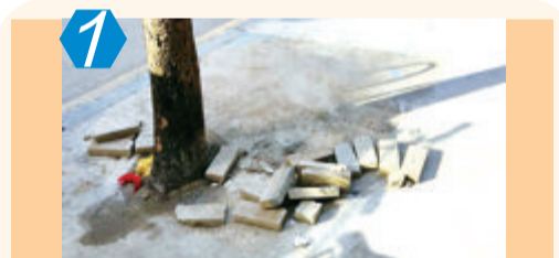
1 测评项目:背街小巷 测评点位:思明区汇文路 测评情况:该点位主要存在非机动车乱停放,设施破损、锈蚀、残留,沿街乱堆放、乱摆放,户外招牌广告破损和垃圾清理不及时等问题,测评成绩72.00分。
