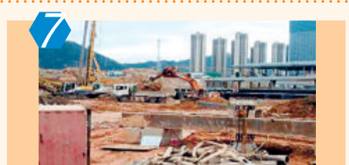
7 考评项目:扬尘防治(专项考评) 项目名称:厦门北高铁交通综合体基坑支护工程 监管单位:市建设局 建设单位:厦门公交集团场站开发有限公司 基本情况:该项目场内大面积黄土裸露未采取覆盖等防尘降尘措施,施工道路硬化、湿化不足,现场存在严重扬尘污染问题。
