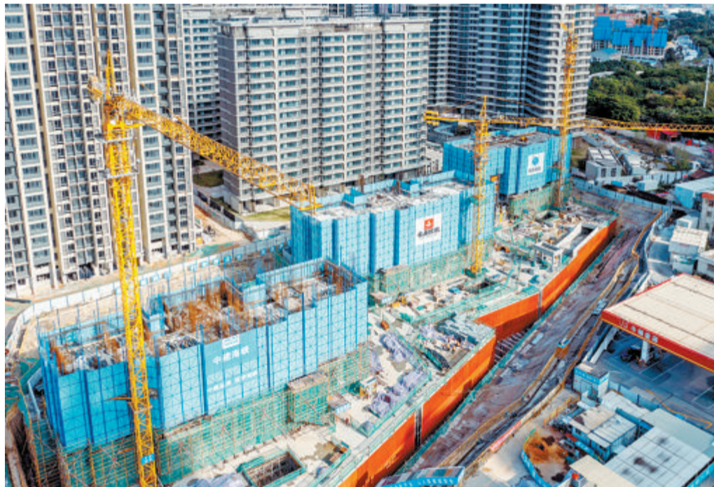
在湖里东部,各安置房项目正在不停地“长高”“变大”。图为金林湾花园安置型商品房四期。
