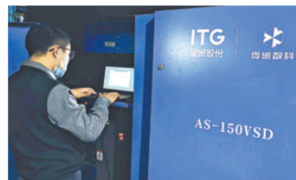
▲启润零碳数科为日照五莲轮胎工厂建设了一套智慧空压站。
