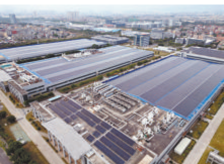
厦门祥达光学分布式光伏建筑一体化项目。
