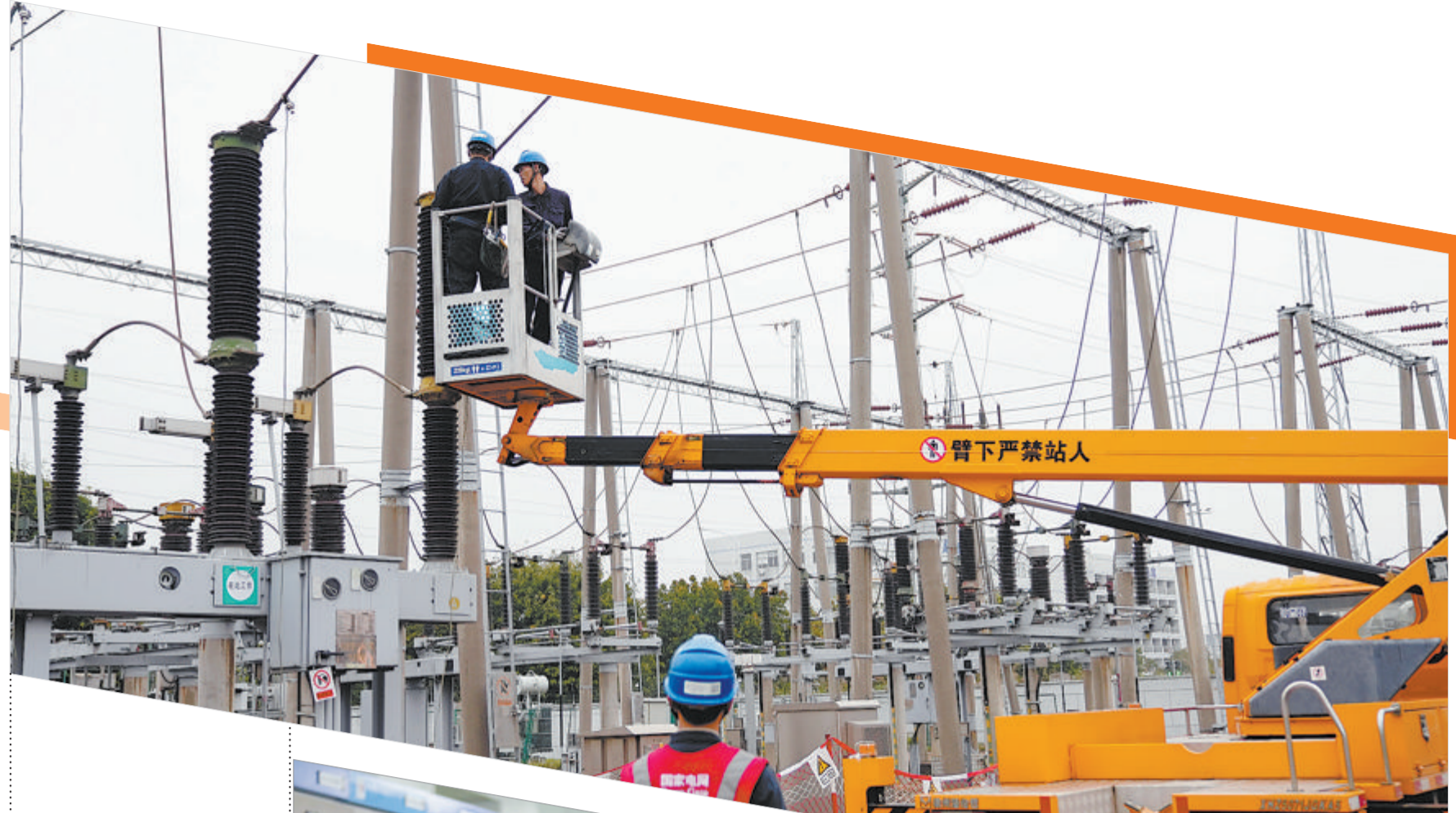
2023年1月,国网厦门供电公司工作人员在110千伏灌南变电站开展检修。(张程摄)
