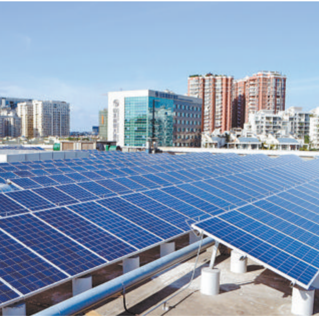
厦门SM商业城的太阳能光伏发电站项目每年可节约标准煤407吨。
