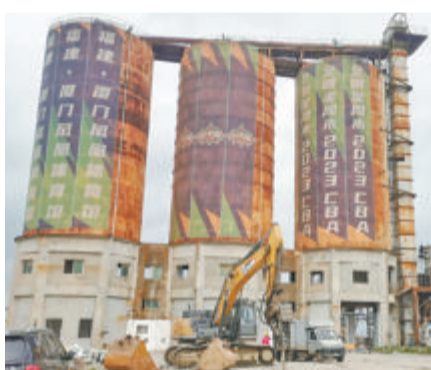
刘五店港务码头的3个30米高的水泥罐体及设备被拆除前。(刘小东 摄)
