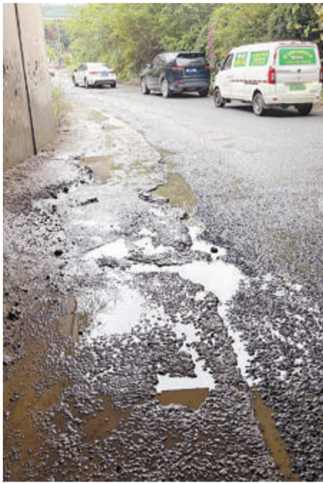
该路段存在不少坑洞。
