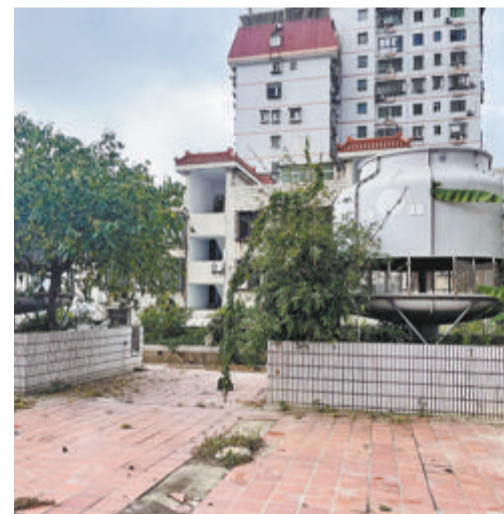
文屏大厦裙楼四楼和五楼之间露台上的空调冷却塔。
