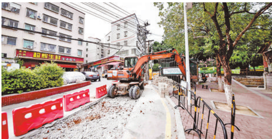
▲叶厝社区正在进行强弱电管网改造作业，改造后将进一步完善基础设施、消除安全隐患。(林志杰摄)
