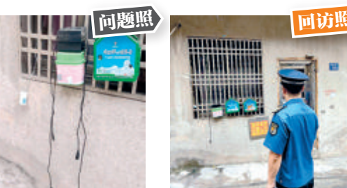
▲翔安区郑坂北里162号乱拉电线问题。经现场核查,该问题未整改。
