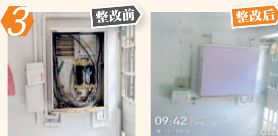
▲同安区陆丰里26号楼道设施破损。经现场核查,该问题已整改。
