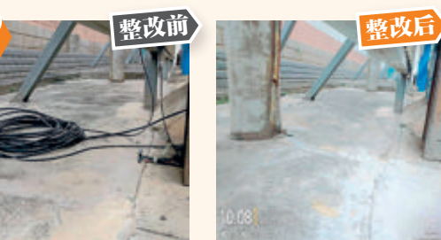
▲湖里区厦门市禾山中学宣传栏线缆裸露问题。经现场核查,该问题已整改。
