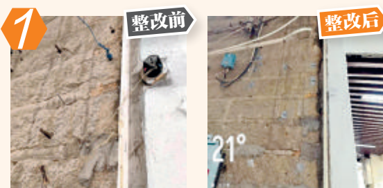
▲思明区大学路53-104号设施残留问题。经现场核查,该问题已整改。
