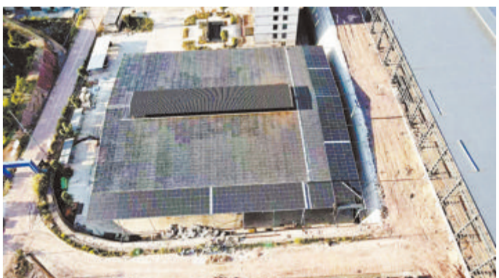
厦门港务控股集团在松溪建设的首个工商业光伏项目并网发电。
