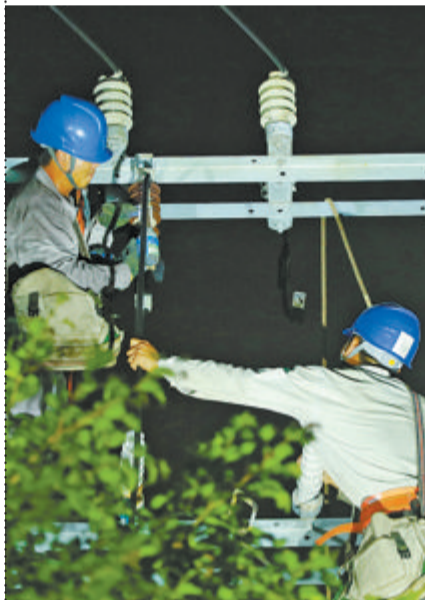
▲7月29日,国网厦门供电公司支援泉州抢修队连夜对10千伏后路线南埔支线3-1#甲杆南埔村#3变电站故障进行抢修。(葛胜武 摄)
