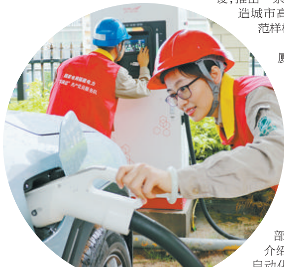
厦门供电公司加强V2G充电桩运维巡视。(叶成才摄)
