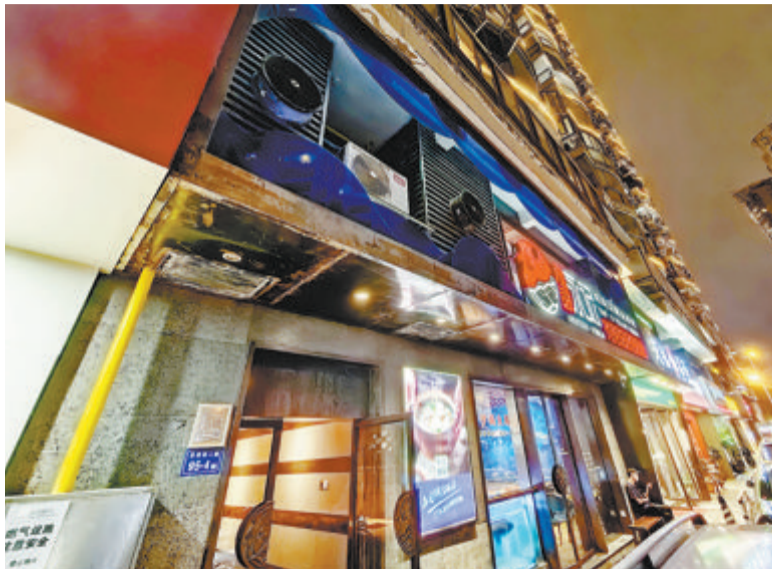
餐饮业一楼外的排气扇。
