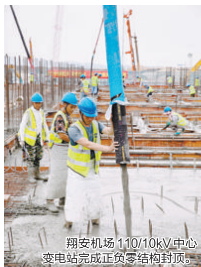
翔安机场110/10kV中心变电站完成正负零结构封顶。建成投运后将供应航站区、飞行区、货运区、工作区等项目用电。
