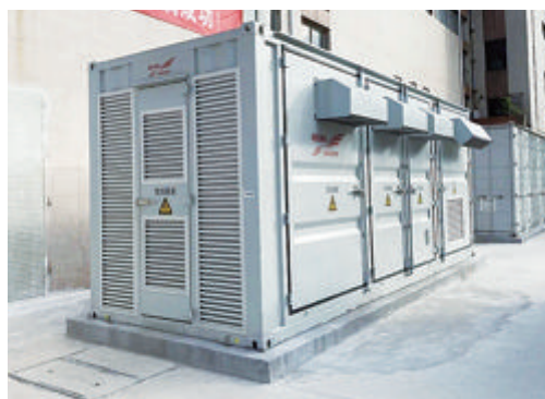
科华数能深圳南山热电厂配套储能9MW/9MWh黑启动项目。
