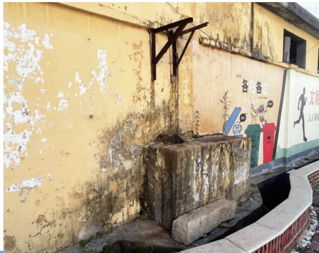
苏厝新宅里11号一面墙壁破损脏污严重。
