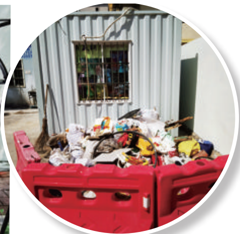
■ 建筑垃圾露天堆放未及时清运。
