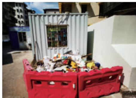
建筑垃圾露天堆放未及时处理。
