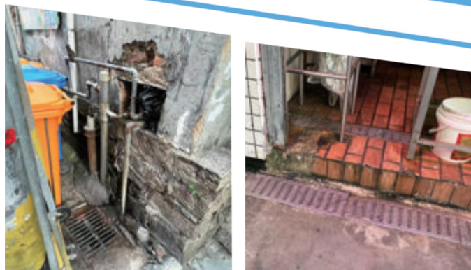
垃圾投放点后方卫生死角。 73号摊位后方地面脏污。
