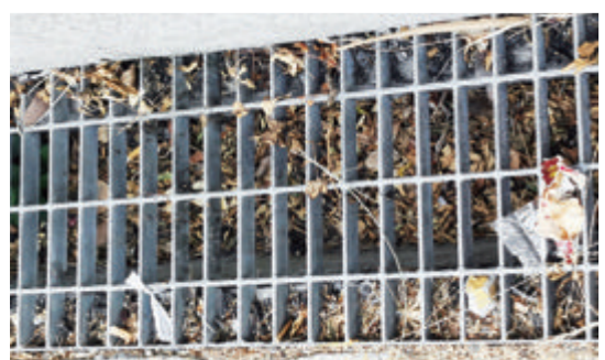
■湖滨南路一条排水沟里积满垃圾，易造成堵塞。
