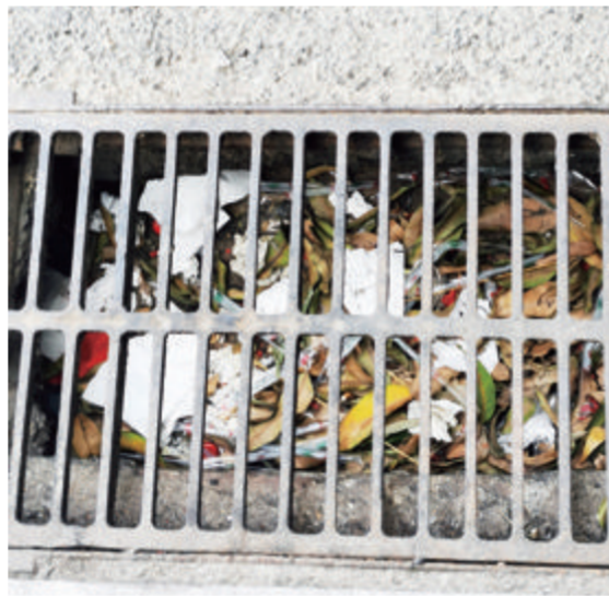
■建南路和杏林东路交会路口窨井盖上存在绿化垃圾。
