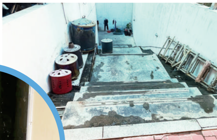
▲禾祥东路32-2号地下室通道两侧杂物乱放。 ▲湖光路72号101室对面的消防设施缺失。
