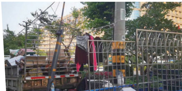
世纪嘉园小区外围,有人在电力设施之间拉线晾晒衣物。
